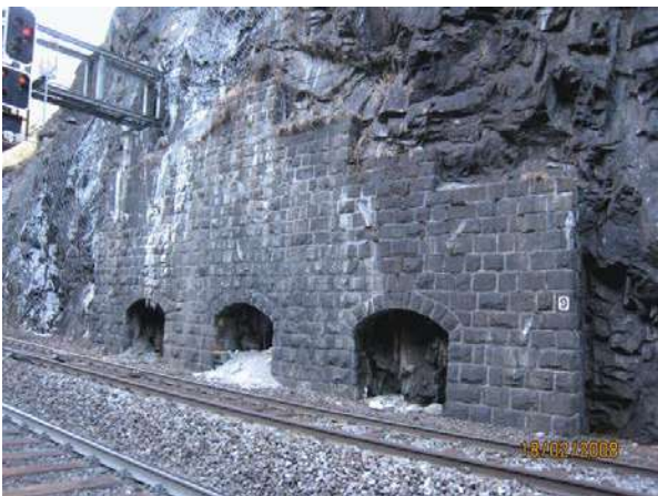
Bild 5: Verkleidungsmauer vor Einsturz
