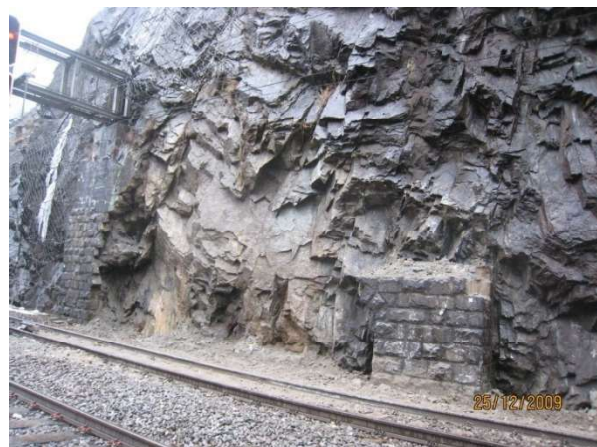
Bild 6: Mauerrest nach Einsturz
