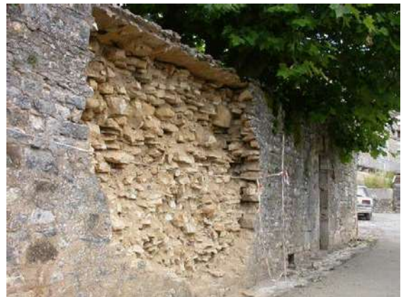
Bild 2: Ablösung des Mantelmauerwerks
